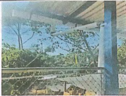
Foto 7: Sustrucción de bajada de agua pluvial, tubo PVC 3" de Módulo Aulas.
